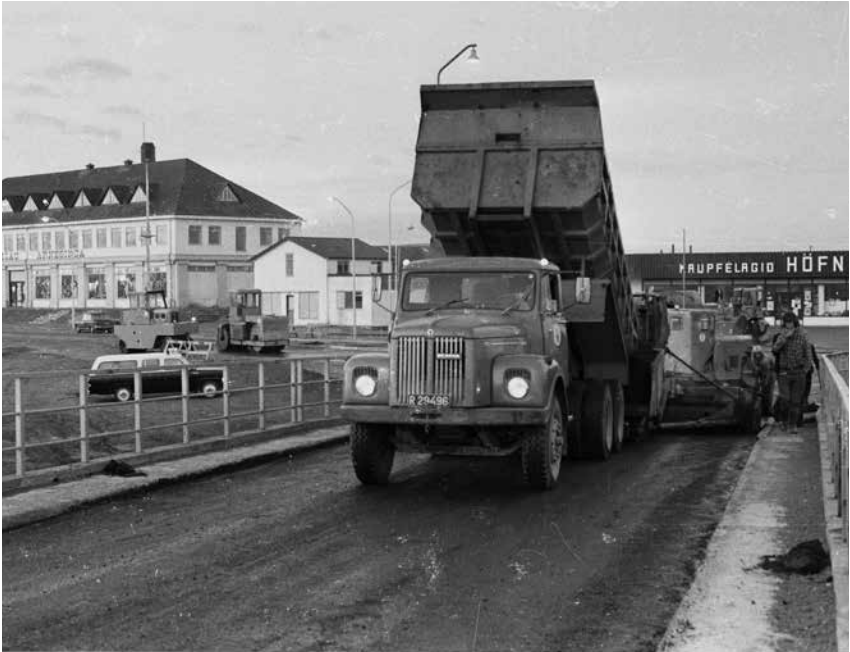
Viðgerð á brúargólfi Ölfusárbrúar um 1970. Verslanir Kaupfélags Árnesinga og Kaupfélags Hafnar í bakgrunni. Ljósmyndari Tómas Jónsson 2011/14_TJ_01767.
